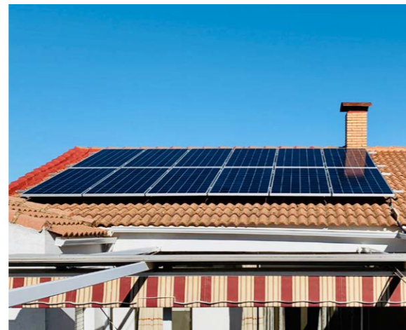
► Instalación de autoconsumo fotovoltaico instalado en la localidad de Zalamea, Huelva.
