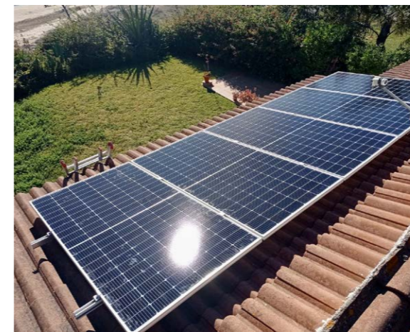
► Instalación de autoconsumo fotovoltaico para vivienda en Mazagón, Huelva.
