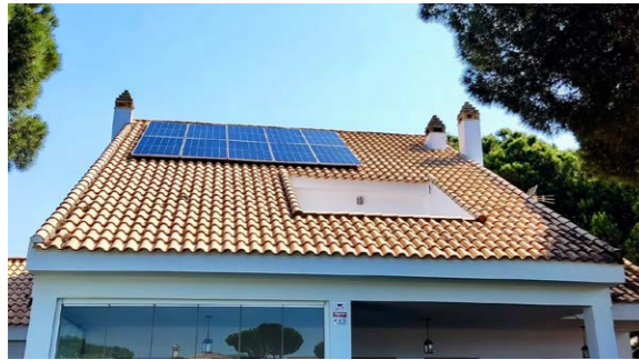
► Instalación de autoconsumo fotovoltaico en vivienda unifamiliar.
